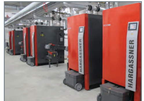
Cascade de 6 chaudières de 200 kW
