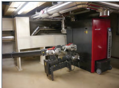
Chaudière de 200 kW avec 2 vis entrée chaudière
