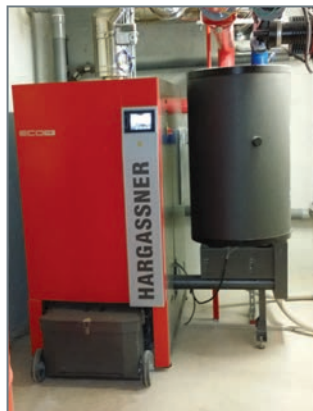
Chaudière EcoPK 150 kW avec RAS 350
