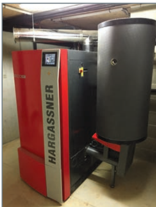
Chaudière EcoPK 70 kW avec silo RAPS
