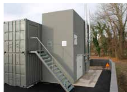
Firma Zweimüller in Ennsdorf, 2 x 90 kW pellets
